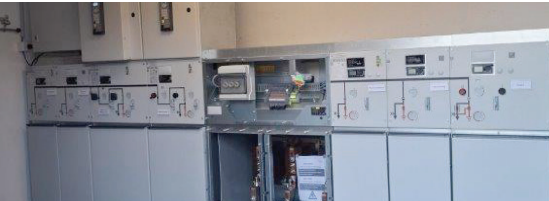
Transformatorsteuerung, noch nicht angeschlossen, TS-Rathaus
