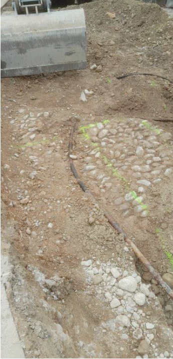
Papierbleileitung Vorstadt mit alter Strasse
