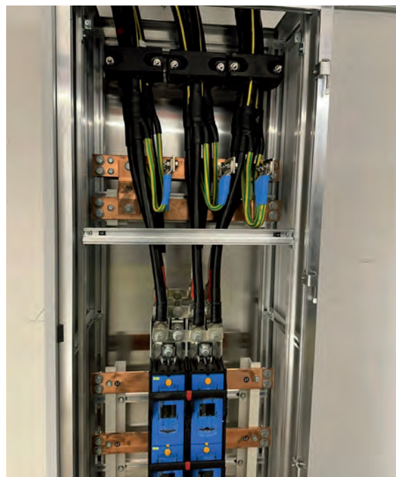
Kabelanschluss in Niederspannungsverteilung
