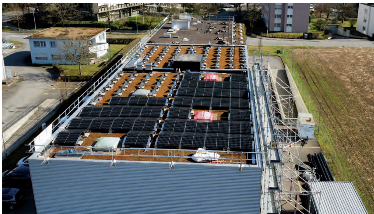
Solaranlage im Areal der EGS
