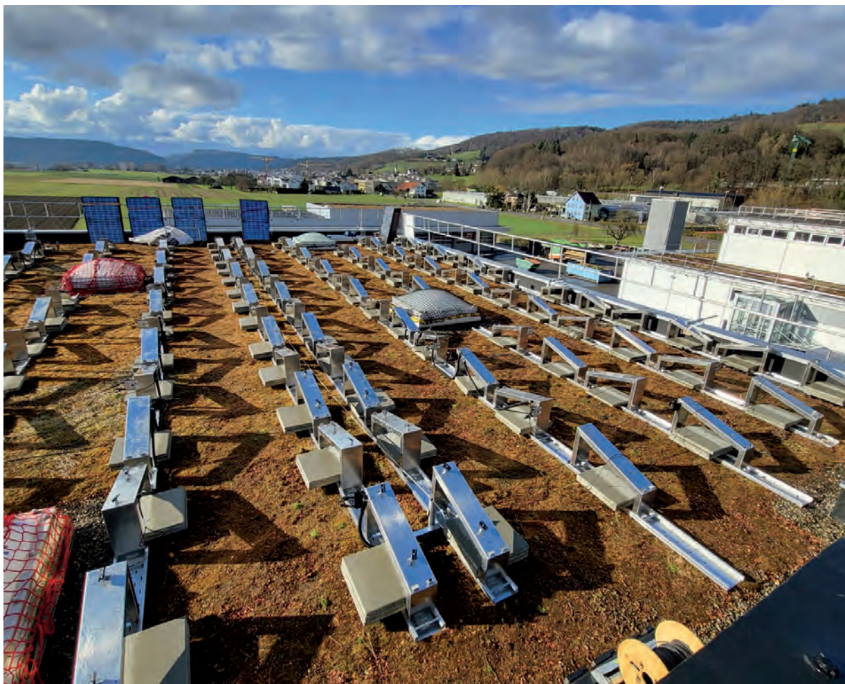
Solaranlage im Areal der EGS
