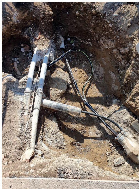
Netzstörung Arkadenweg, Untersiggenthal
