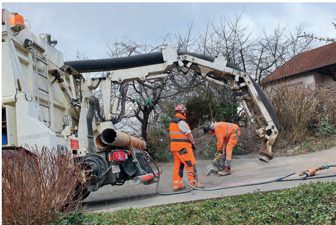
Netzstörung Arkadenweg, Untersiggenthal
