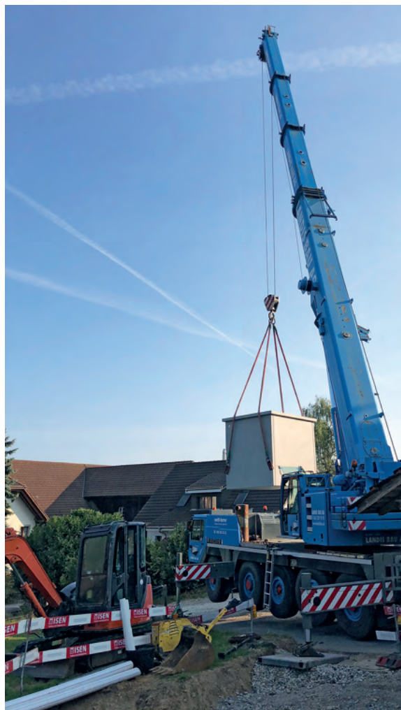
Ablad Transformatorenstation Steinenbühl
