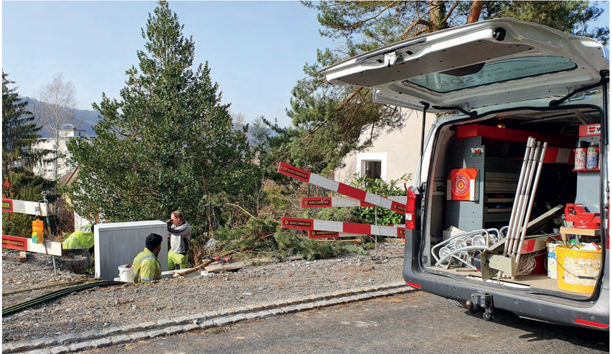
Verkabelung Verteilkabine Birkenstrasse
