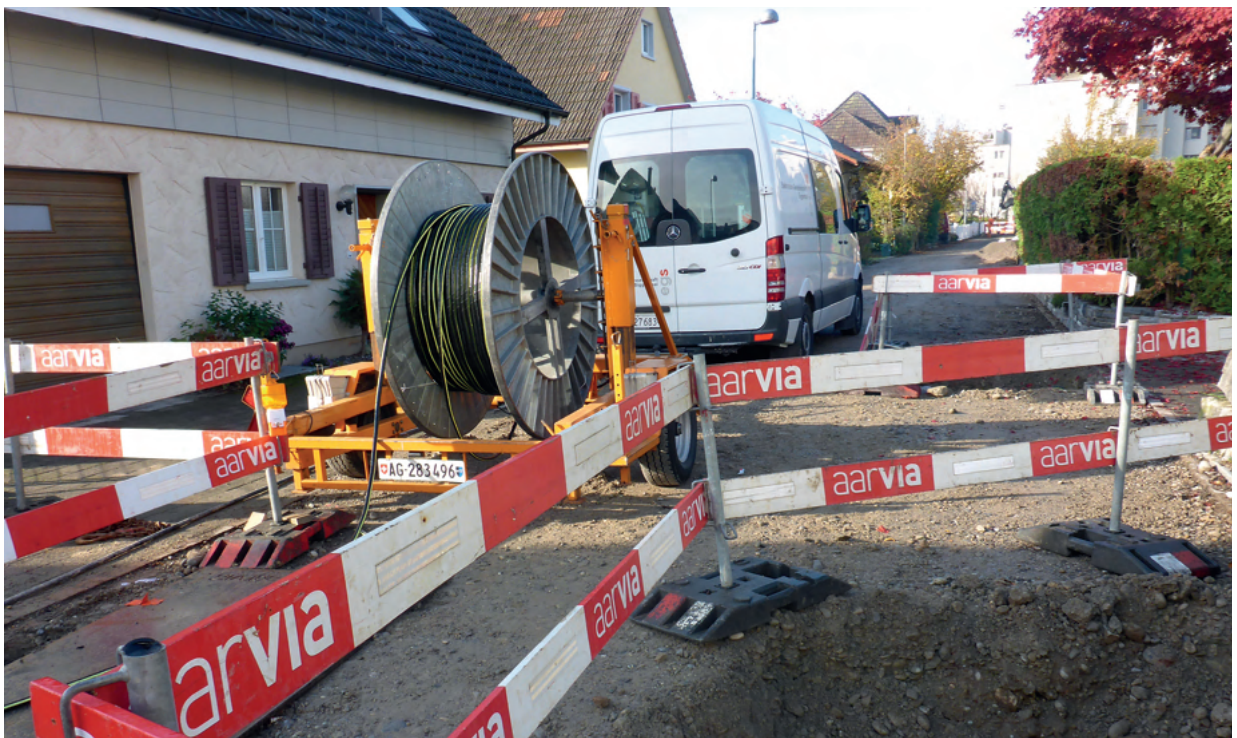
Kabelzug Haldenstrasse, Nussbaumen
